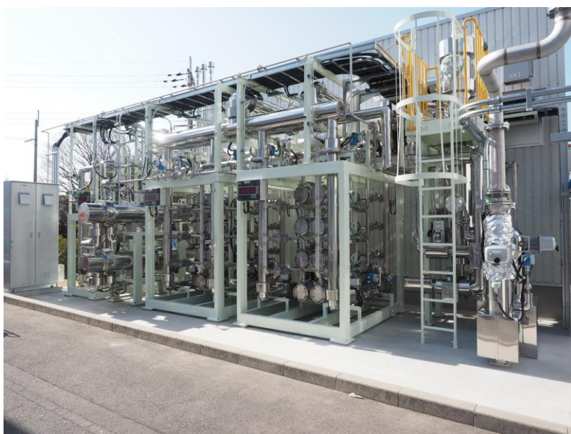
CO 2 ガス回収実証試験機（滋賀事業所内）
